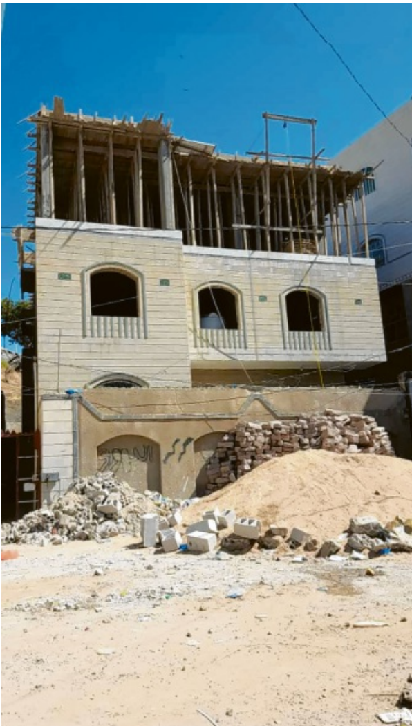
Das Kinderhaus der Jemenhilfe in Taizz während der Ausbauphase. Mittlerweile ist der zweite Stock fertig.
